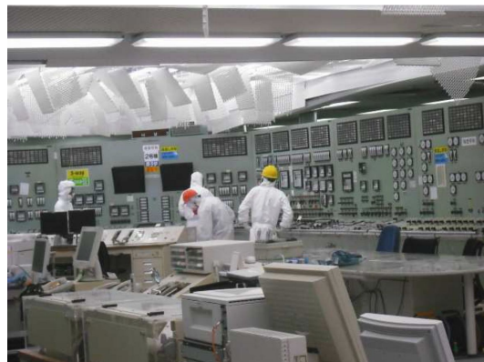
図7：2号機の制御室
