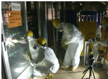
図5：2号機での仮設計器の設定
