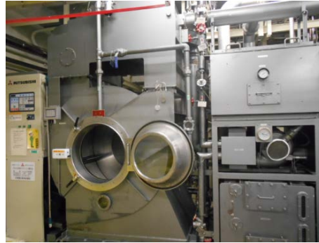
洗濯設備 (エマルジョン式)
