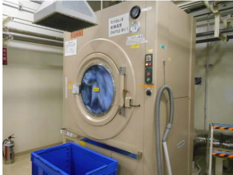
洗濯設備 (水洗式)
